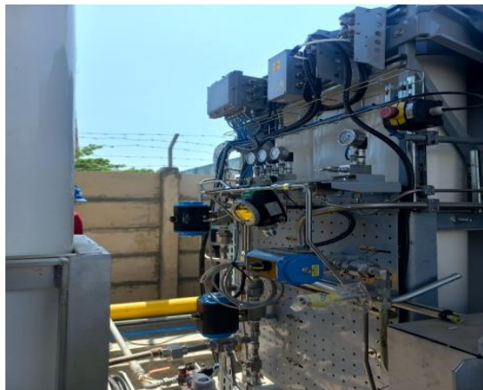
Gambar 14. System Acturator Ball Valve (Sumber : Dokumen Pribadi)
