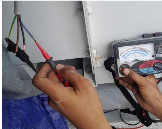
Gambar 9. Megger terhadap motor fan gas cooler (Sumber : Dokumen Pribadi)
