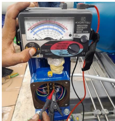
Gambar 7. Megger terhadap motor water pump (Sumber : Dokumen Pribadi)
